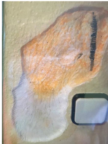
Figura 1. Imagen de una pared dañada por un paciente con pica. Se pueden observar las huellas de dentición marcadas en la misma
